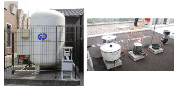
左：災害対応ユニットを設置したバルク貯槽 右：訓練の様子
